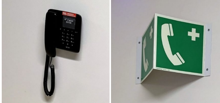
Figure 7 - Téléphone de secours et sa signalétique
