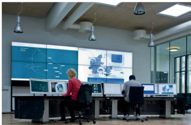
Fig. 1 : réplique du centre de contrôle du Smart Grid de Bornholm au DTU de Lyngby près de Copenhague (photo DTU)
